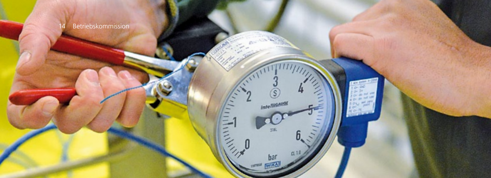
Plombierung nach erfolgreicher Kontrolle.
