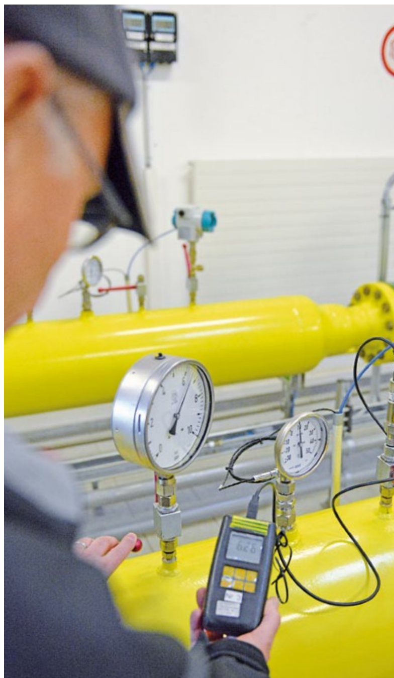
Kontrolle des Auslösedrucks beim Sicherheitsabsperrentil.
